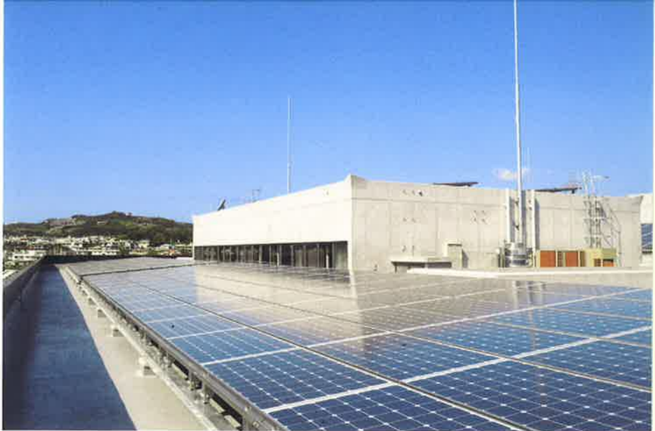
県内公共施設に設置している太陽光発電パネル。架台は自社製から他社のもまで幅広く設置し、常に試験データをとっている
