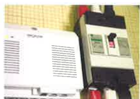
分電盤の左横に設置されているのが「HEMS」。コンパクトで場所を取らない大きさ
